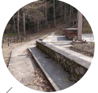
OLTÁR ÉPÍTMÉNY ROSSZ ÁLLAPOTBAN VAN
