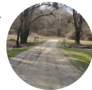
TÚL KESKENY HÍD, FELÚJÍTÁSRA SZORUL
