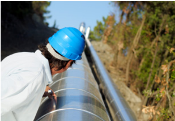
Távfűtő gerincvezeték (Forrás: estar)
